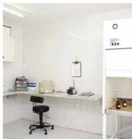
Laboratório sem funcionar após reforma
